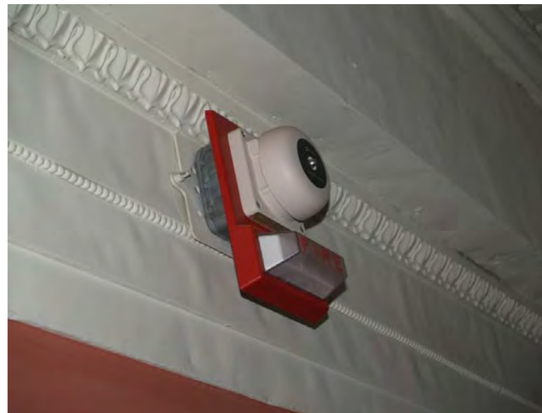
Fire Alarm Annunciator
